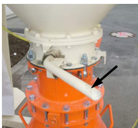
Рис. 32: Закрытие выпускной заслонки хранилища
